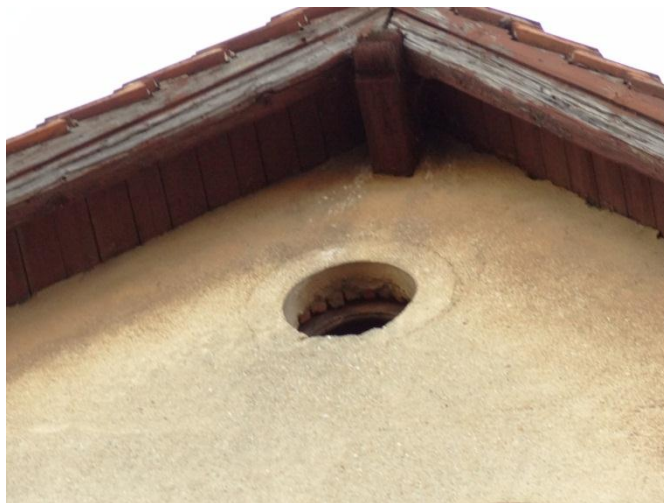
Fot. 4 Okno stanowiące potencjalny wlot nietoperzy na strych
