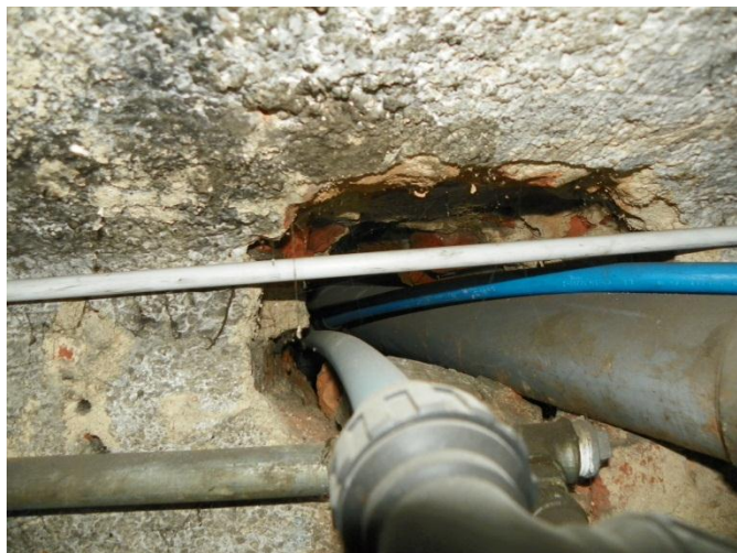
Fot. 3 Dziura wokół rur w murze piwnicy
