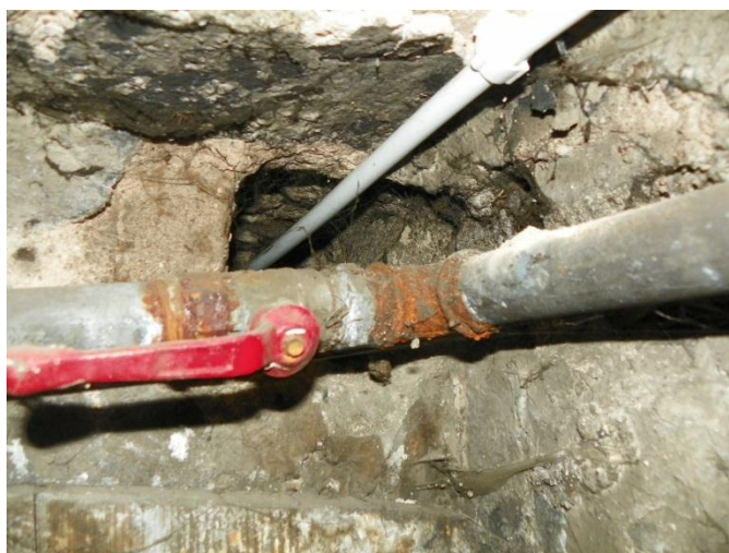
Fot. 3 Dziura wokół rury w murze piwnicy
