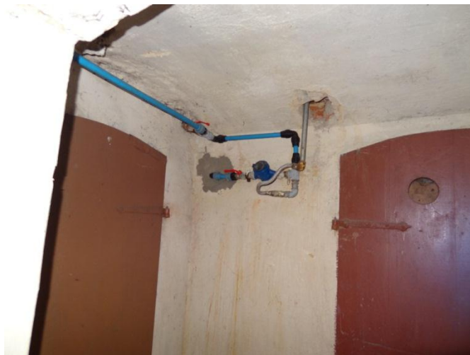
Fot. 2 Dziura wokół rury w murze piwnicy
