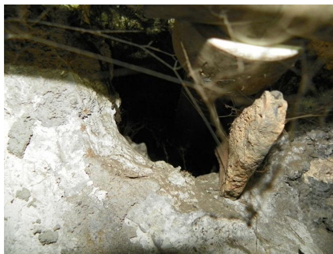
Fot. 4 Dziura wokół rury w murze piwnicy
