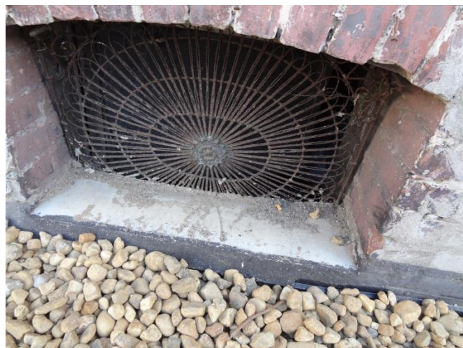
Fot. 4. Zasłonięte od wewnątrz okno piwnicy
