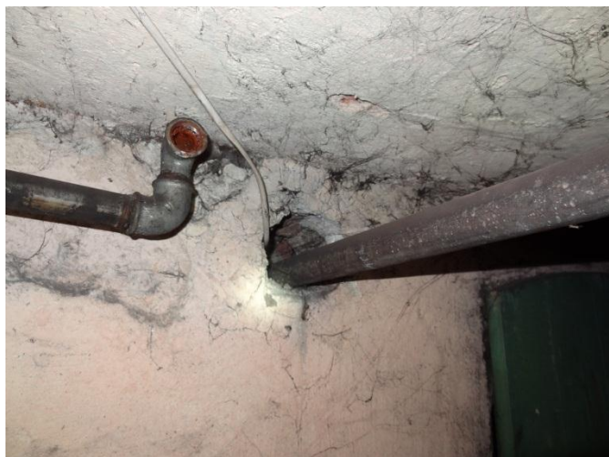
Fot. 3 Dziura wokół rury w murze piwnicy
