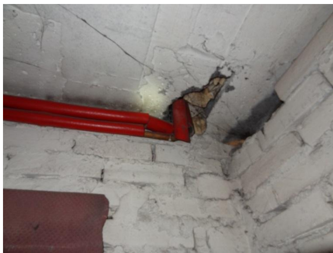
Fot. 2 Dziura wokół rury w murze piwnicy
