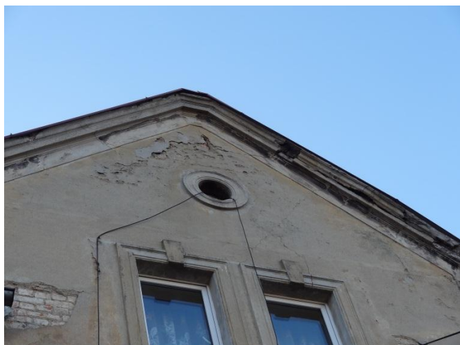
Fot. 5 Okno stanowiące potencjalny wlot nietoperzy na strych
