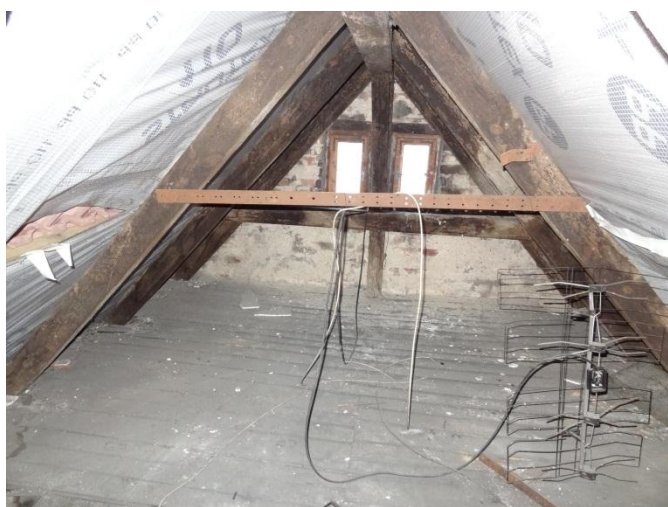
Fot. 5 Strych i okna - potencjalne wloty
