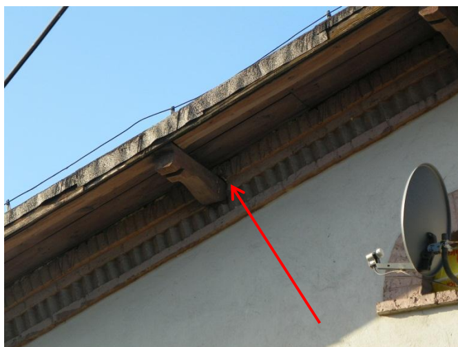
Fot. 6. Szczelina przy krokwi
