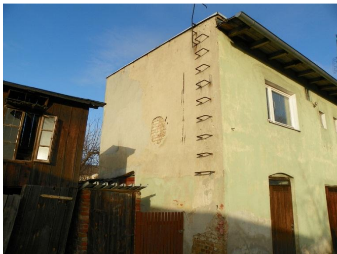
Fot. 4. Budynek posiada ubytki w elewacji, ale brak szczelin i otworów
