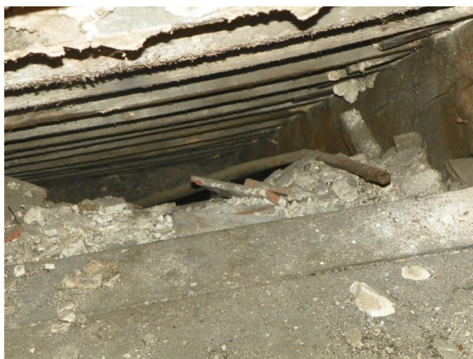
Fot. 3 Szczelina między dachem a podłogą - potencjalny wlot nietoperzy na strych
