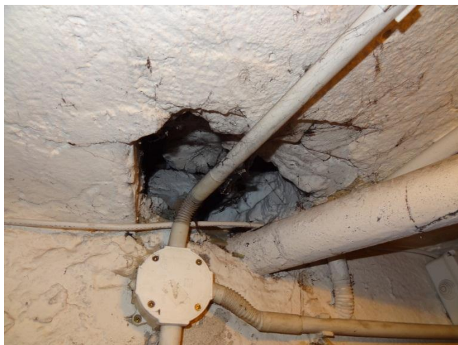
Fot. 3 Dziura wokół rury w murze piwnicy
