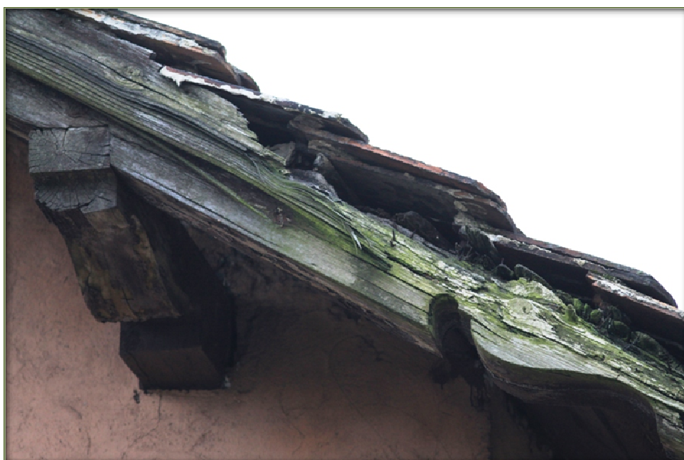
Fragment dachu budynku przy ul. Kolejowej 10. Widoczne ubytki pod dachówką umożliwiają odbicie lęgów przez ptaki.
