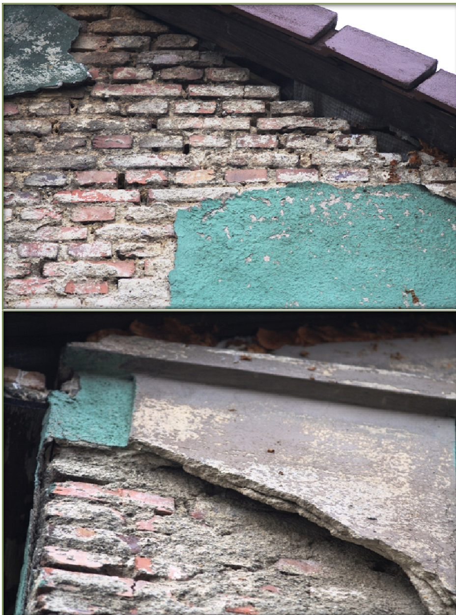
Fragment szczytu budynku przy ul. Sikorskiego 36. Widoczne szczeliny i nisze umożliwiające odbycie lęgów przez ptaki.
