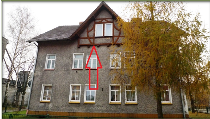
Ubytki w elewacji północnej – potencjalne miejsca lęgowe ptaków.
