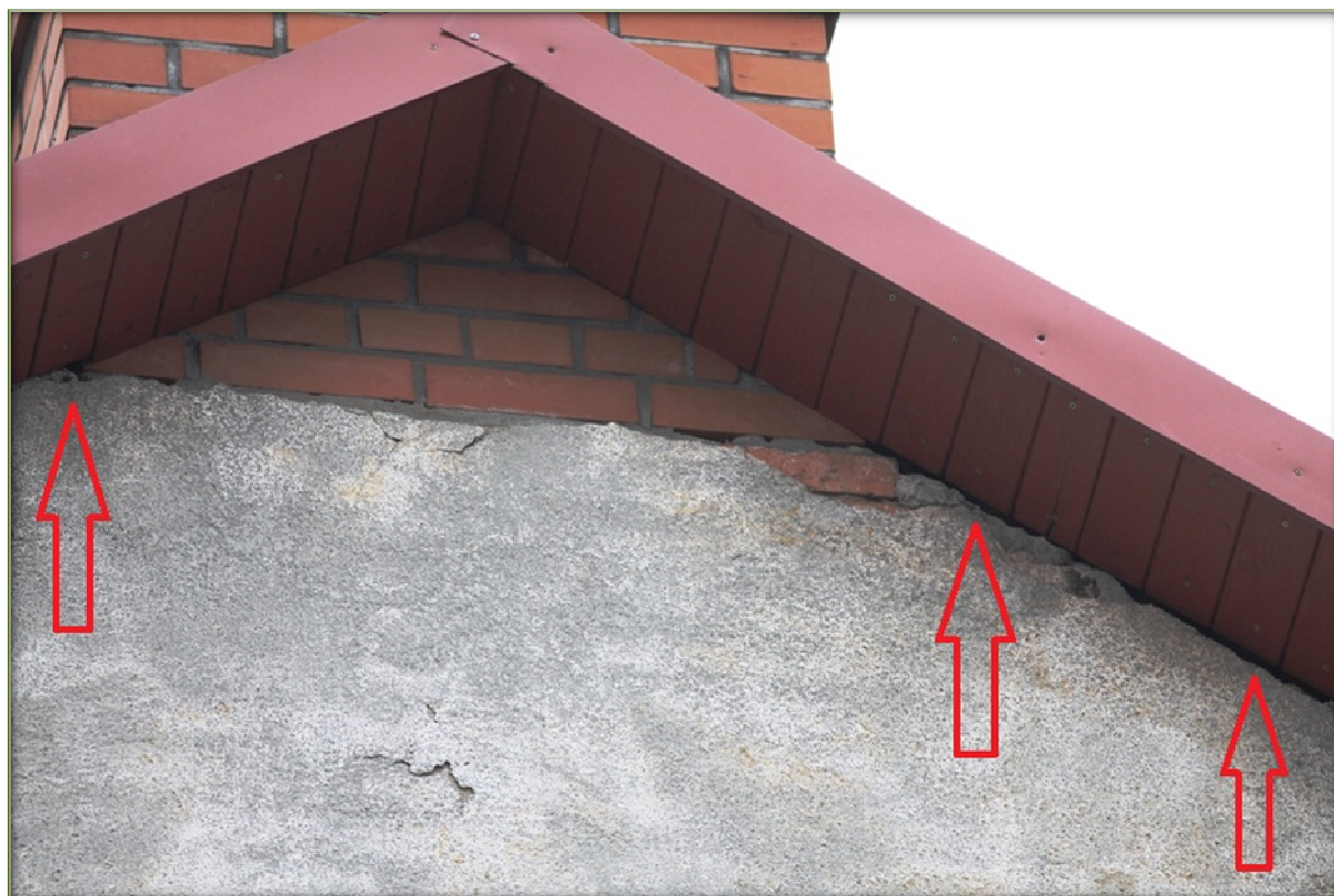
Szczeliny w szczytowym fragmencie budynku (elewacja od strony zachodniej).
